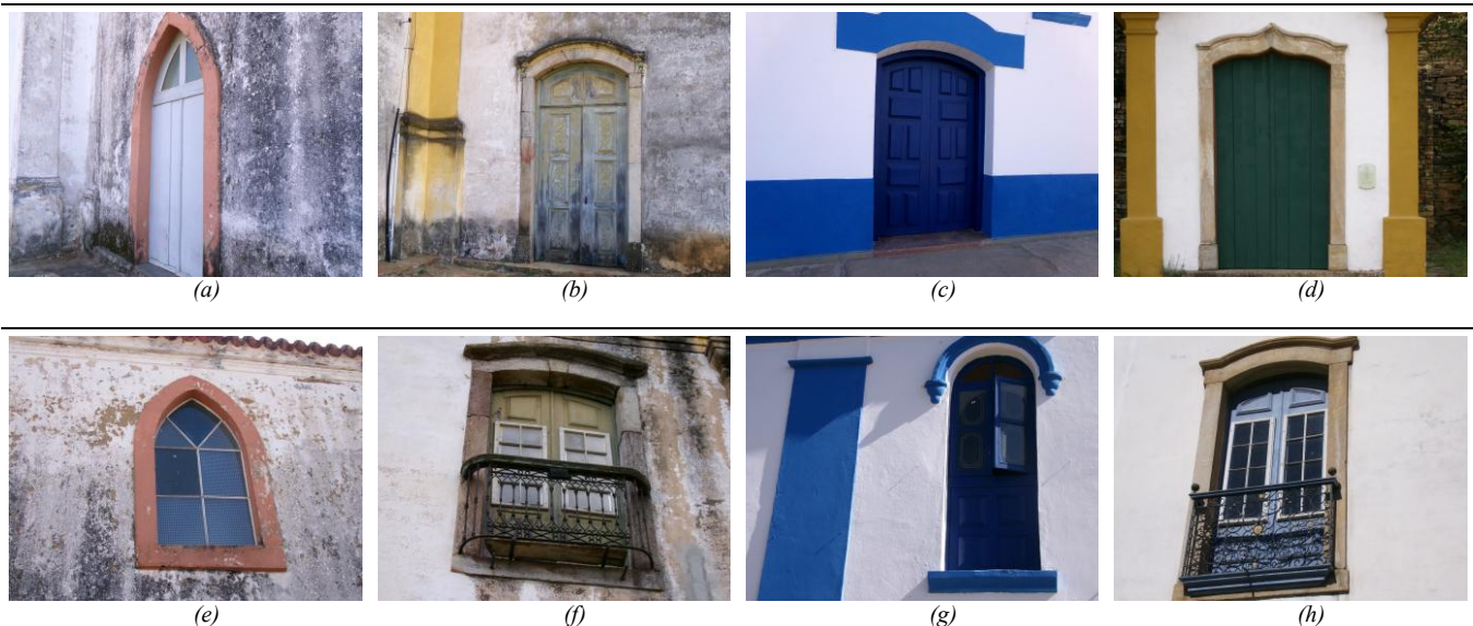
Fig. 2 - Exemplos de Imagens Classificadas Após a Rotulagem: (a, b) Portas Com Danos; (c, d) Portas Sem Danos; (e, f) Janelas Com Danos e (g, h) Janelas Sem Danos. Fonte: Imagens do Banco de Dados [1]
